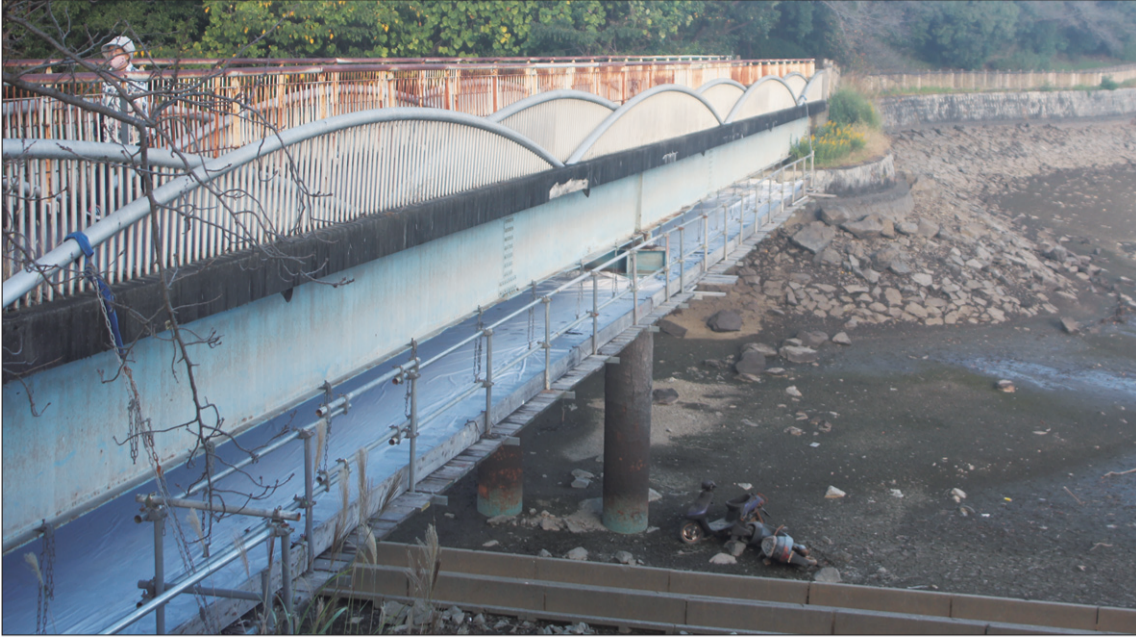
汚水が漏れていた大蓮池の白鳥橋。現在は応急処置がされ、橋の下には樋が設置されている。
