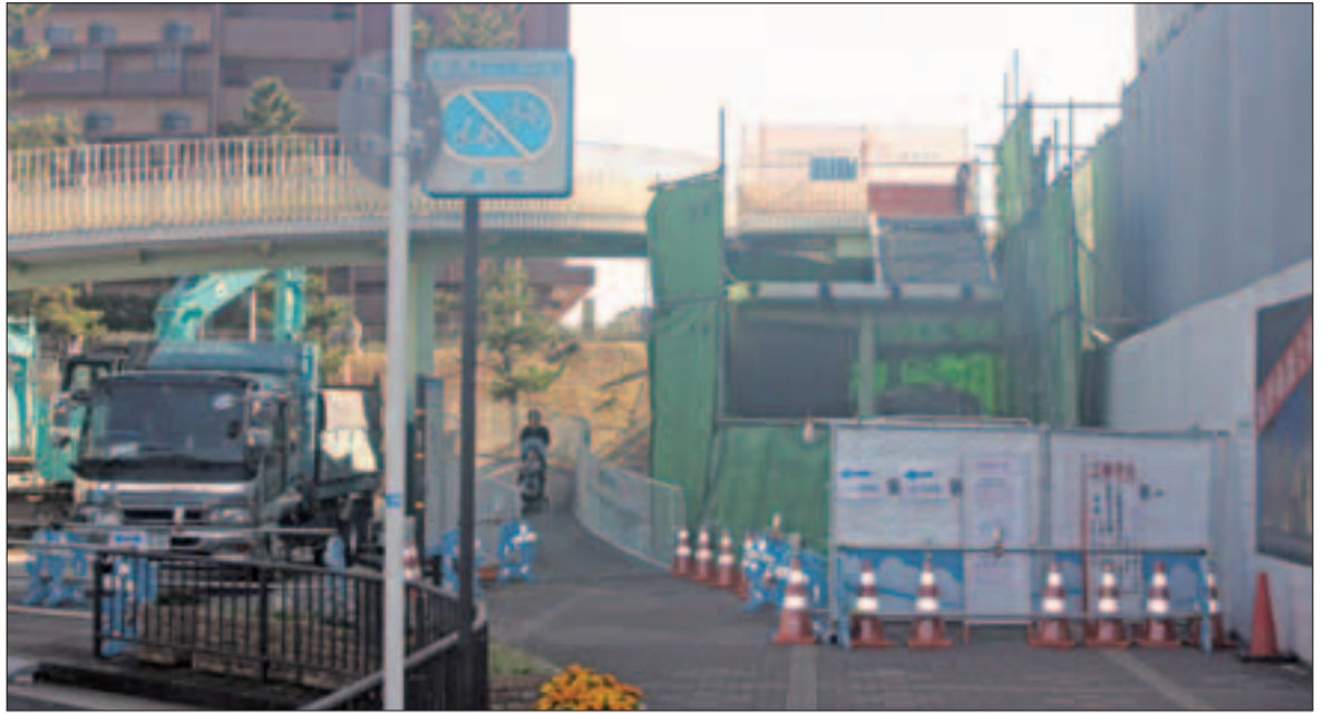
古い階段を撤去し、エレベーターを設置。左側のらせん型スロープも撤去後はスロープ付き階段に。
